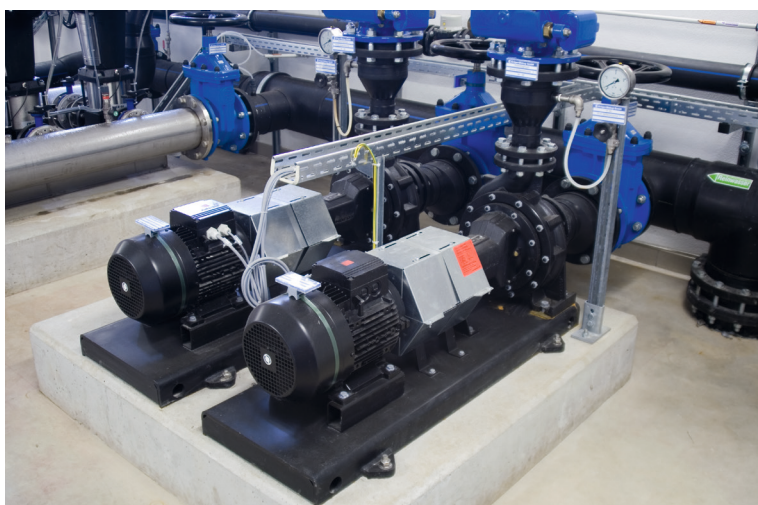
Spülwasserpumpe NK für die Filtrerrückspülung auf einer Anlage in Baruth/Mark
