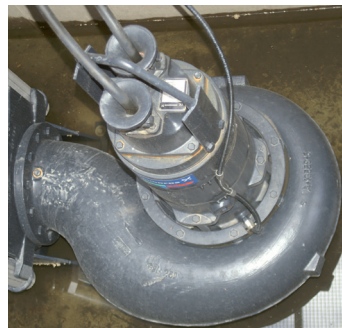
▲ S2 Pumpe mit einer Förderleistung von 350l/s auf der Anlage Wörth am Rhein.
